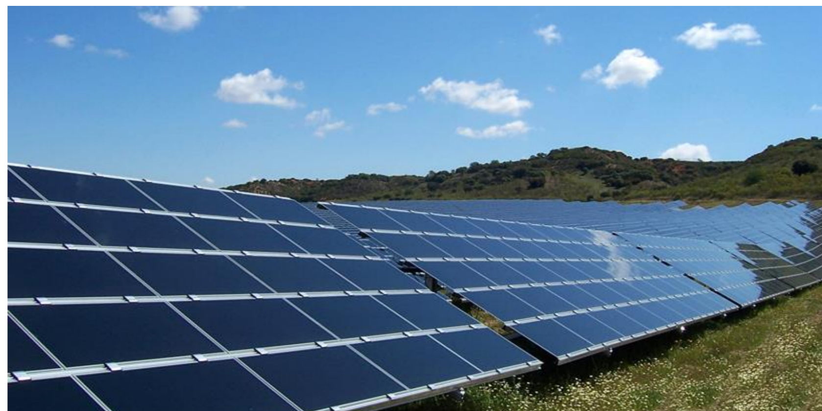
Parc photovoltaïque EDF Renewables de Narbonne
